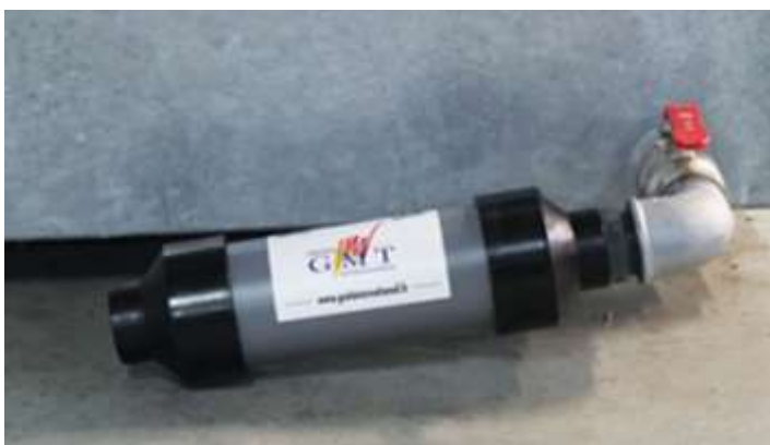
Cartouche de filtration des hydrocarbures en sortie de bac
